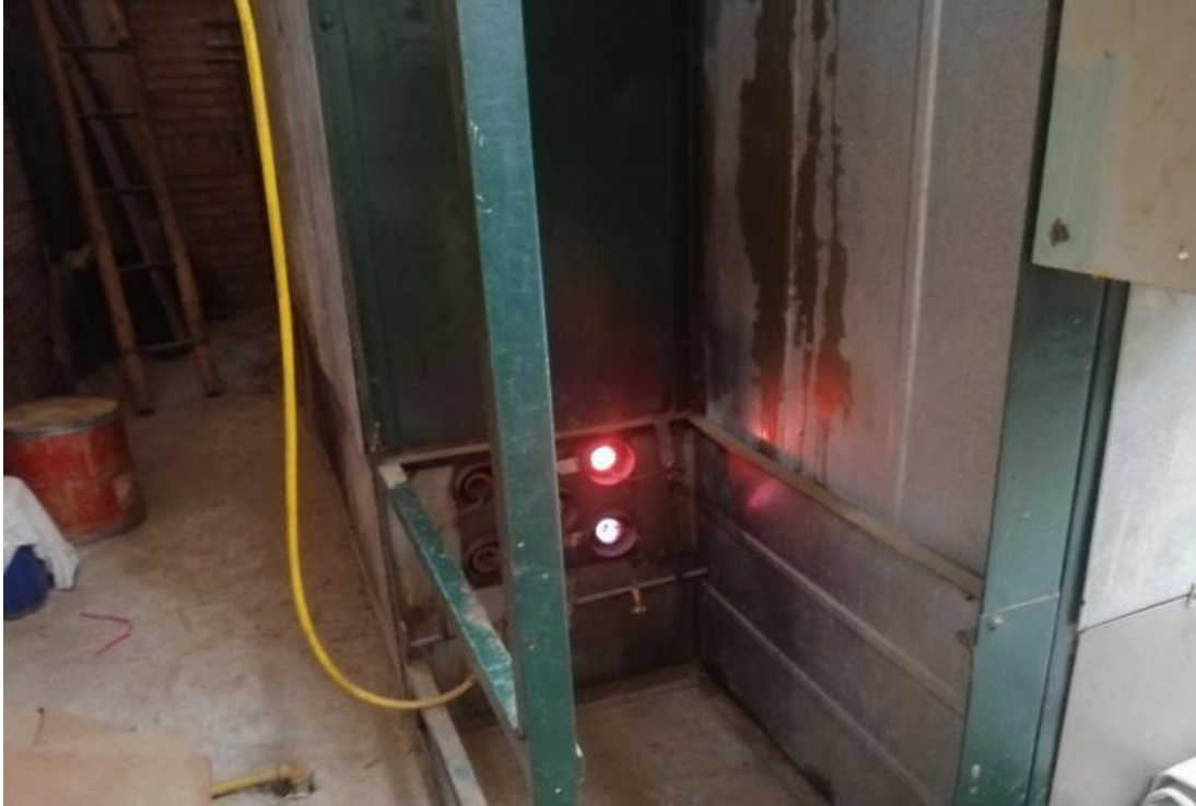
Ilustración 19. Mecheros propulsores del calor
