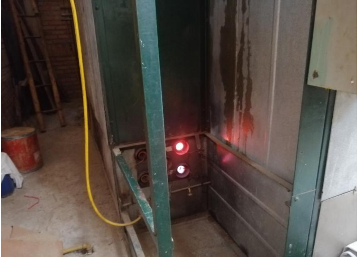
Ilustración 29. mecheros propulsores del calor
