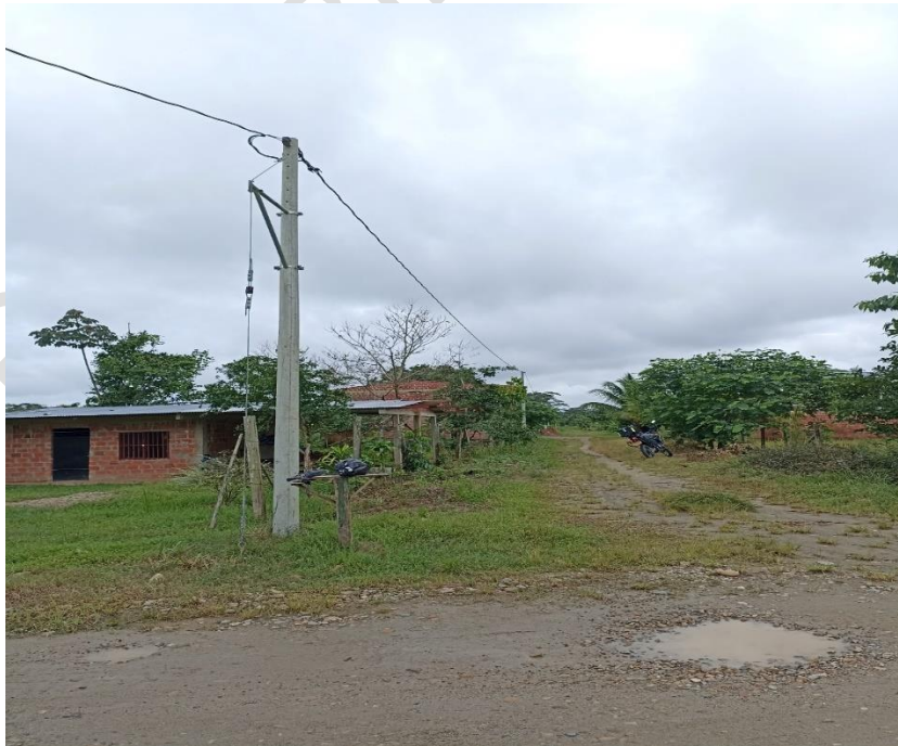
Figura 17. Instalaciones eléctricas residenciales.
