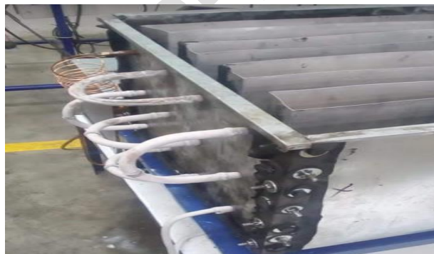
Figura 3: Estructura de los Bancos de Hielo conservación de energía térmica.
